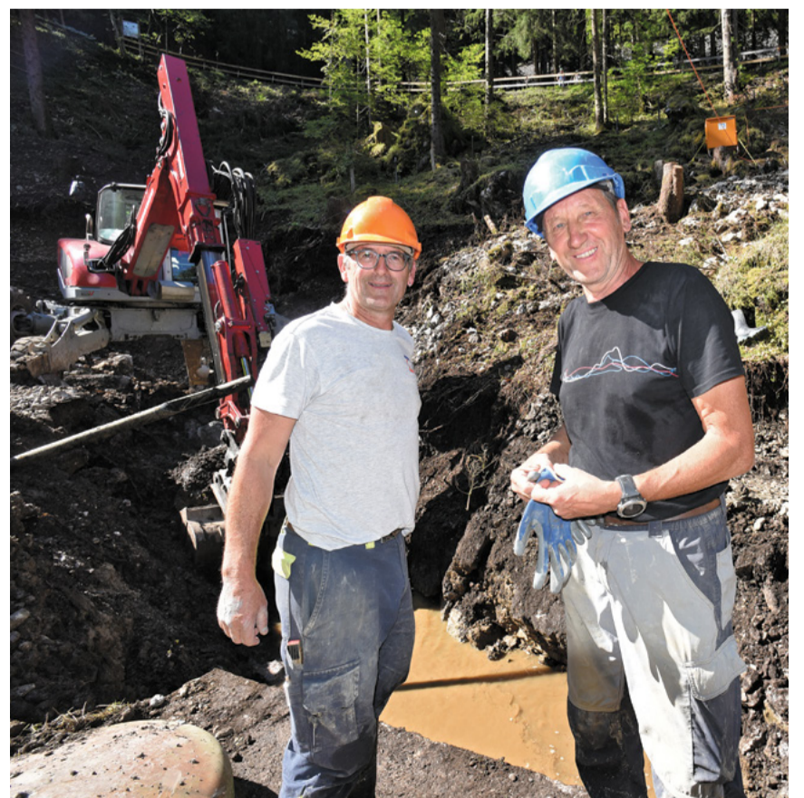
Ruedi Fässler, Brunnenwart bei der Energie- und Wasserversorgung Appenzell, zusammen mit Quellfassungsspezialist Roland Brunner auf der Brunnenkammer der alten vorderen Fassungen.
